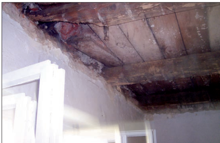
Foto z havárie stropu z roku 2008
